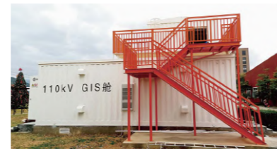
110kV - 220kV GIS Cabin
